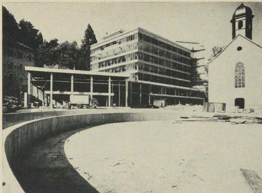
Blick über die zur Tiefgarage führende Rampe auf das neue Kurmittelhaus mit dem Vorbau der Brunnen- und Wandelhalle. Rechts die um ein Joch verkürzte und renovierte altkatholische Pfarrkirche – als ehemalige Spitalkirche das älteste Baudenkmal Baden-Badens.
