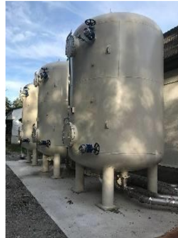
Retentataufbereitung mittels Aktivkohlefiltration
