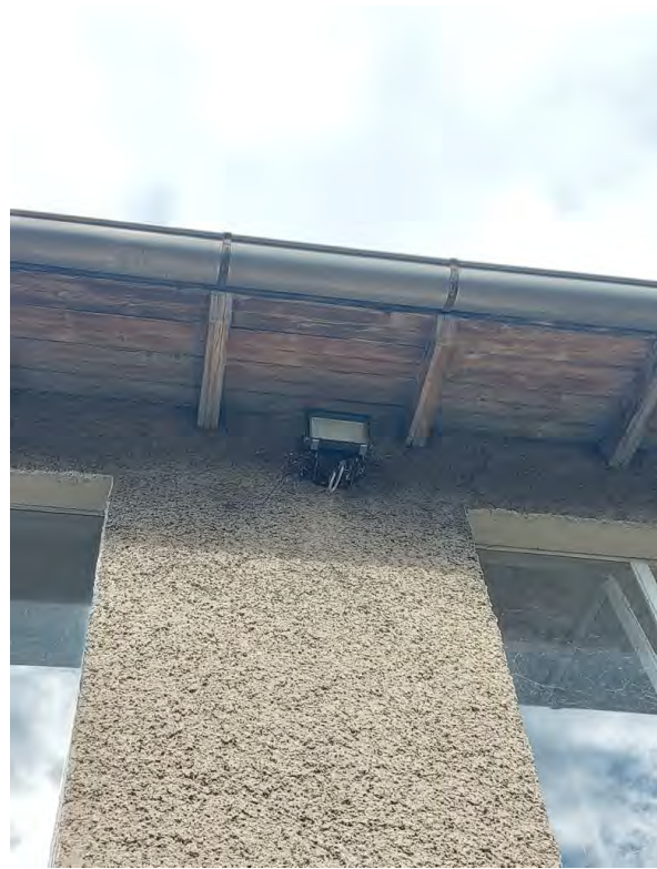
Abbildung 16: Nest der Straßentaube am südwestlichen Gebäude
